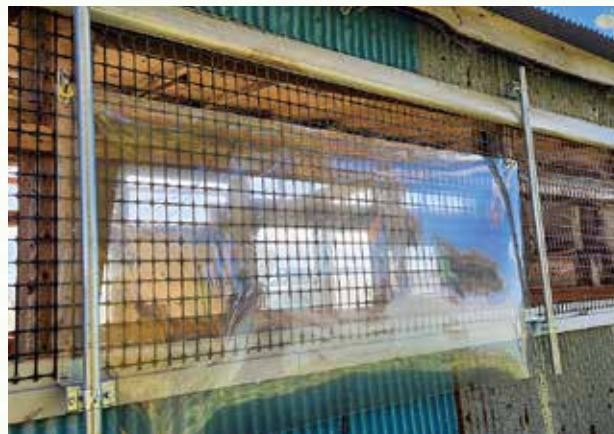
写真3)カーテン下側を塞ぐシート
