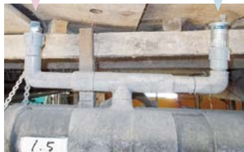
写真4 口径を太くした水道管に接続した吸気弁・排気弁の設置例
