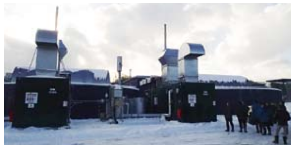
清水町 バイオガスプラント
